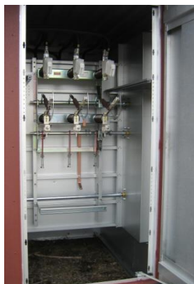
Figur 6. Infallsskydd demonterat ZT19/ZF19.
